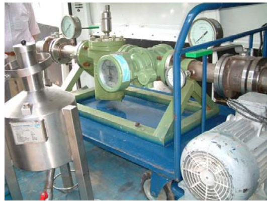
El equipamiento de la estación móvil de aforo de tanques del CNICA
